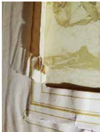
貼りつき箇所
